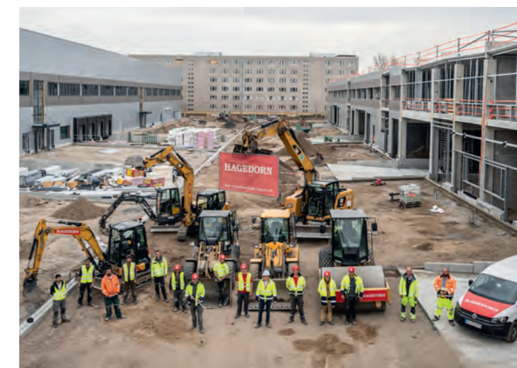
Gleichzeitig, nicht nacheinander, so lautete die pragmatische Lösung: Die Tiefbauspezialisten arbeiteten auf minimaler Fläche.
